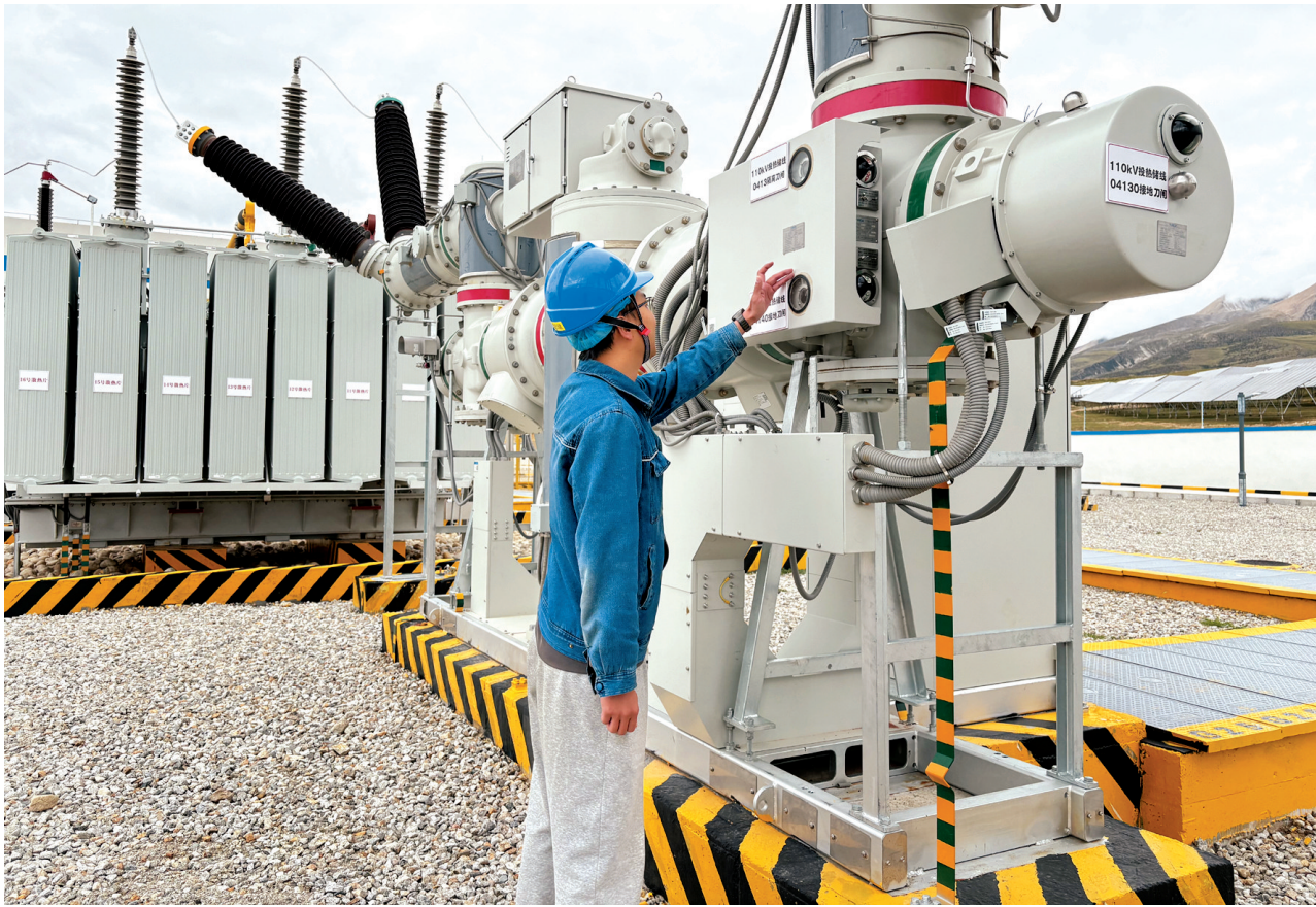
图为工作人员正对设备进行例行检查,确保运转正常。
