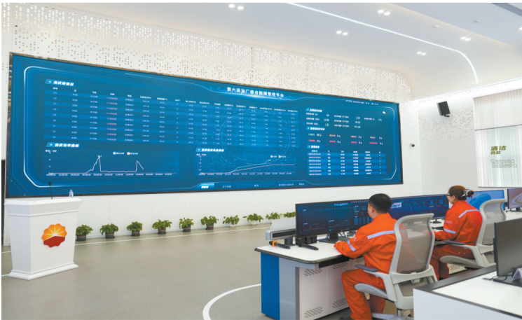
3月25日,工作人员在大庆喇嘛甸油田智慧指挥中心监测新能源设备运行数据。(新华社发)
